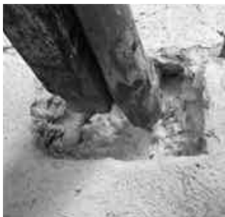
Figura 10. Ecco come si presentava inizialmente la trave, il cui intervento è descritto nel caso precedente.
